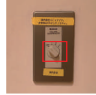
※非常放送のボリューム
